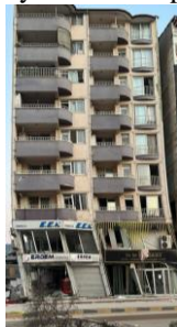
b) Soft storey irregularity (Kahramanmaraş)
